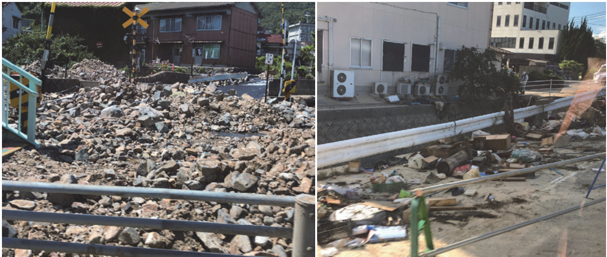
図2 河川氾濫による土砂やがれき：左：三原市内でJRの線路が土砂で埋まっていた様子；右：沼田西町民センター避難所周囲の様子
